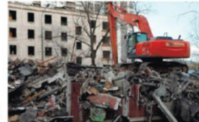
Оценка объема вывоза строительных отходов
